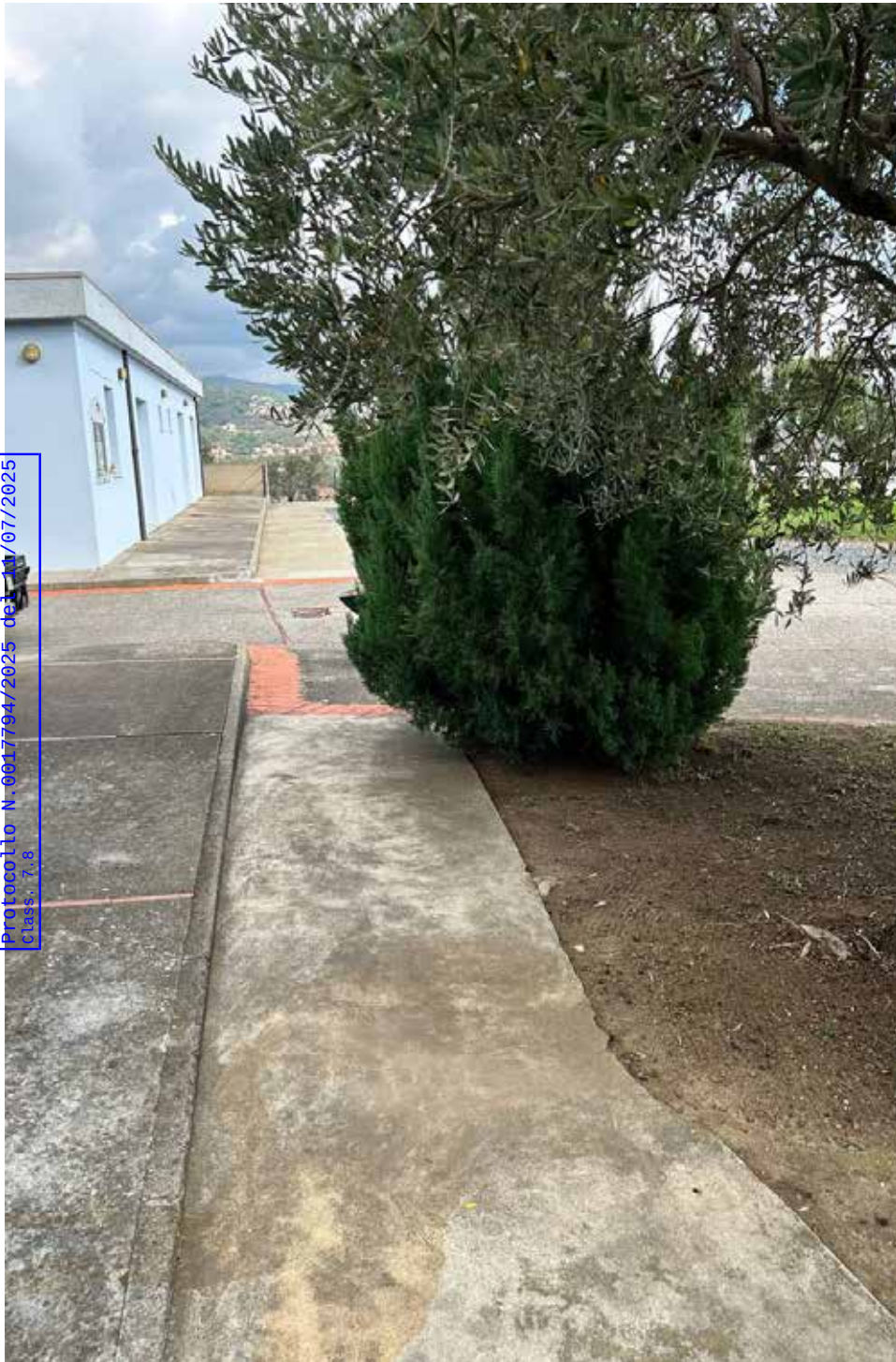
1 - Rampa di accesso ai bagni. Piccolo impedimento, presenza di vegetazione che rende difficoltoso il passaggio.
