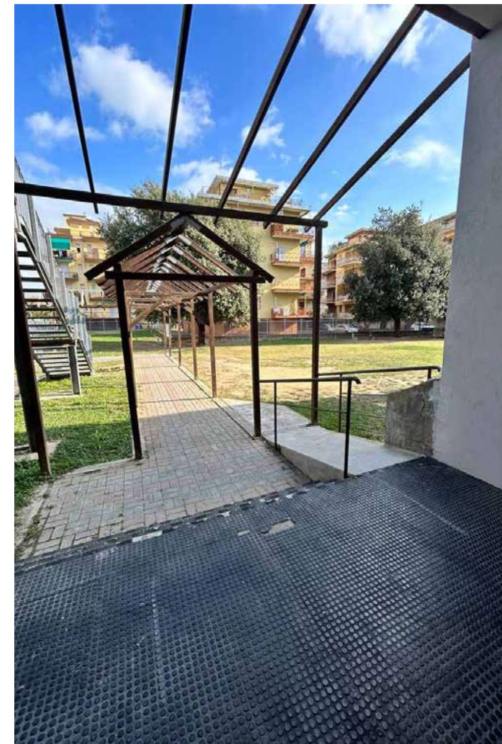
3 - Rampa realizzata per assolvere al problema della barriere architettonica presente, ma non sufficiente poichè pendenza non conforme.
