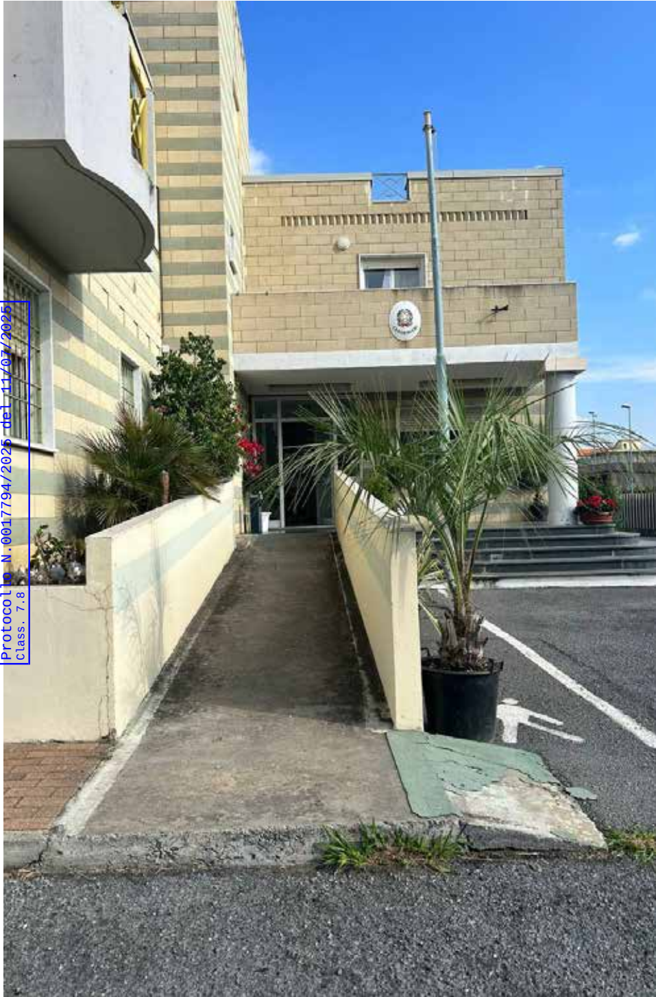
1 - Rampa di accesso alla caserma con pendenza non conforme alla normativa.
