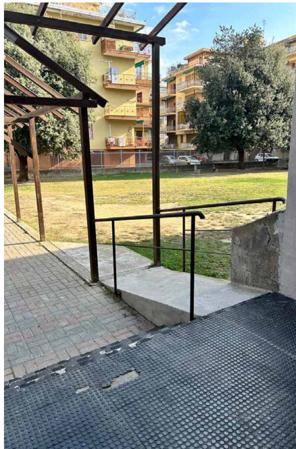
2 - Rampa realizzata per assolvere al problema della barriere architettonica presente, ma non sufficiente poichè pendenza non conforme.
