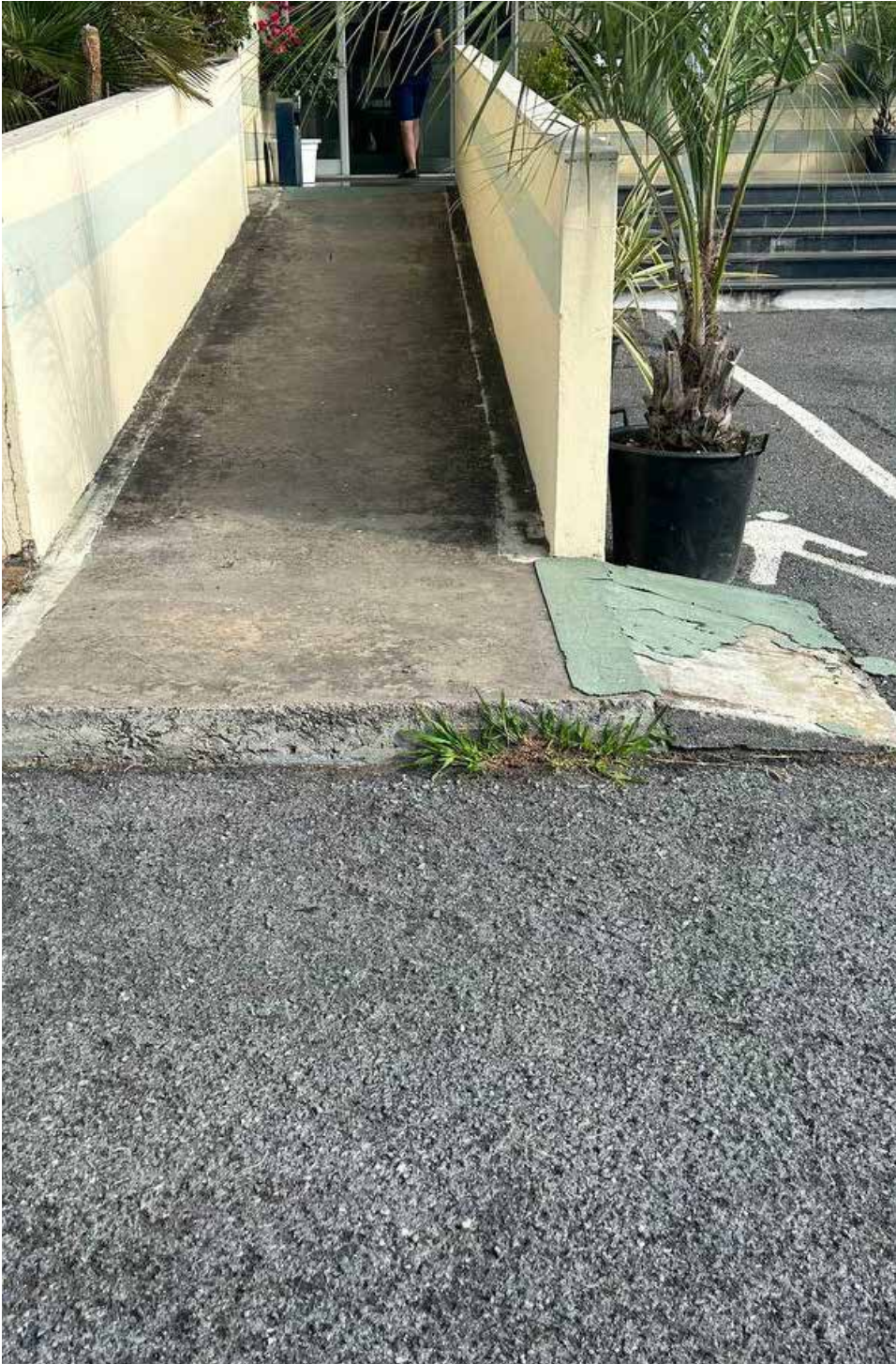
3 - Dettaglio rampa con pavimentazione disconnessa e pendenza non conforme.
