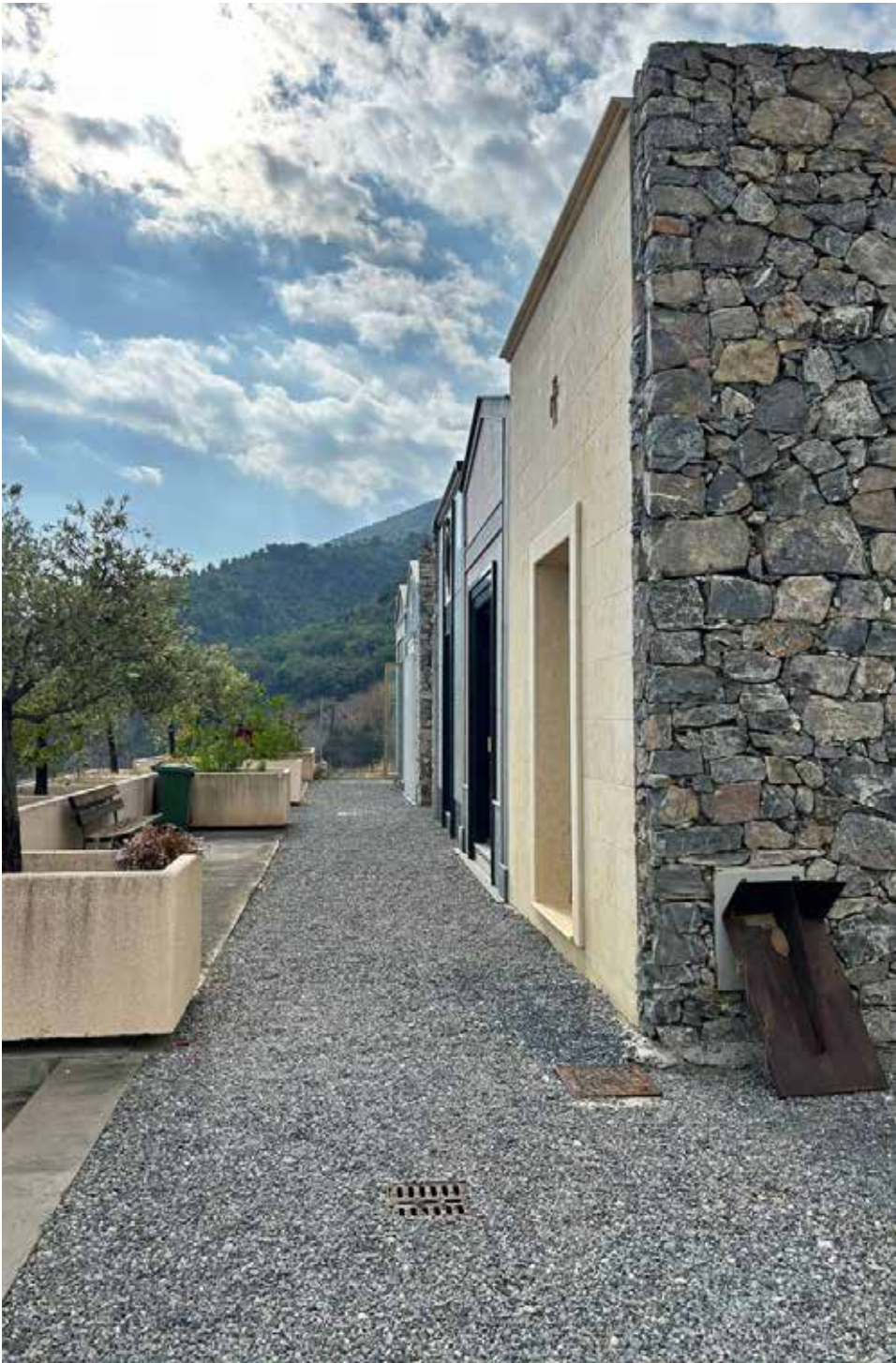
3 - Aree private del cimitero. Presenza di pavimentazione discontinua.
