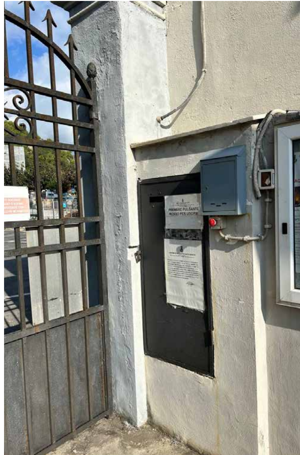
2 - Posizione in altezza non corretta del pulsante per apertura cancello.
