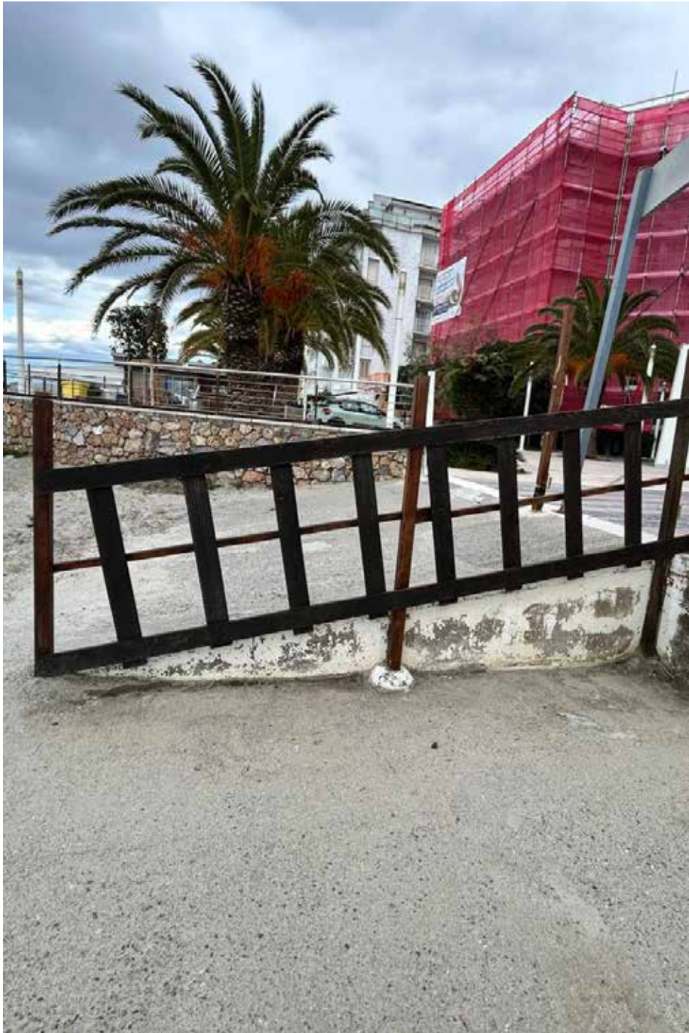
2 -Dettaglio della rampa di accesso con pendenza non conforme alle norme di abbattimnto delle barriere architettoniche.
