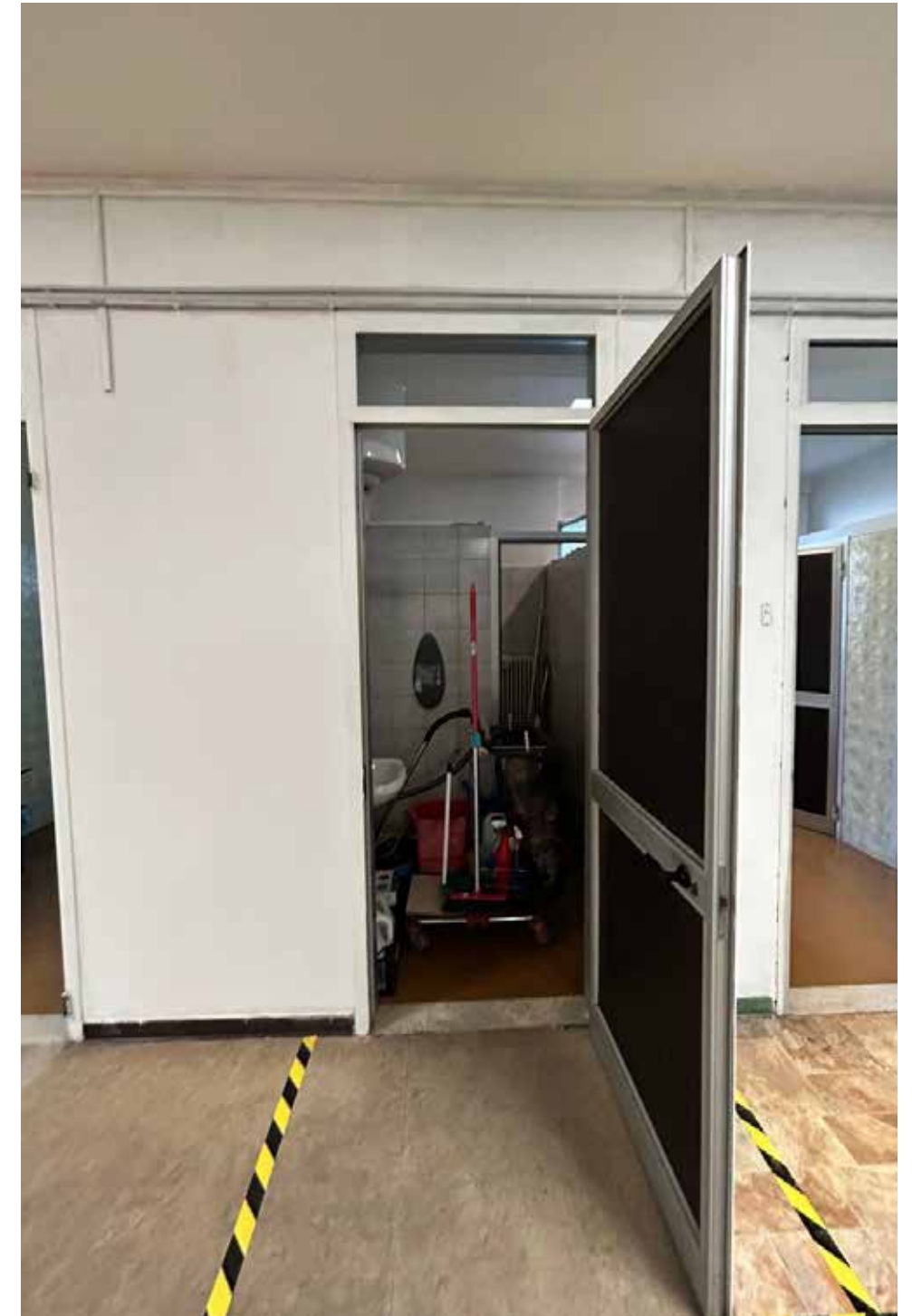
6 - Assenza di bagni per persone disabili, ma spazi predisposti.
