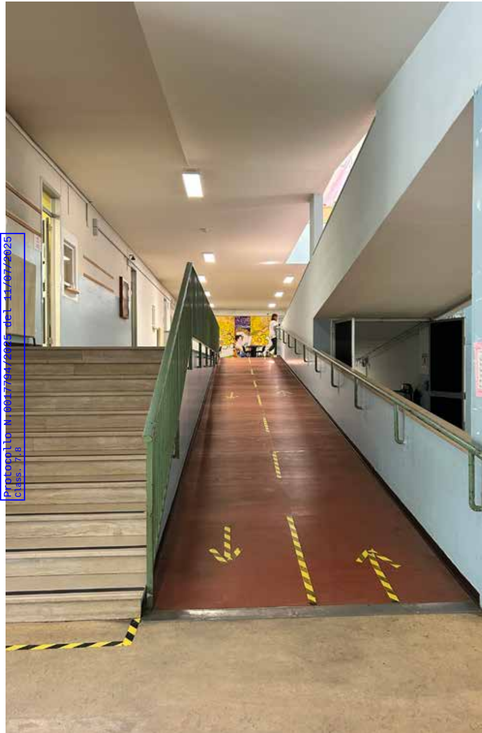
4 - Presenza di rampe interne. Hanno pendenze non conformi alla normativa.
