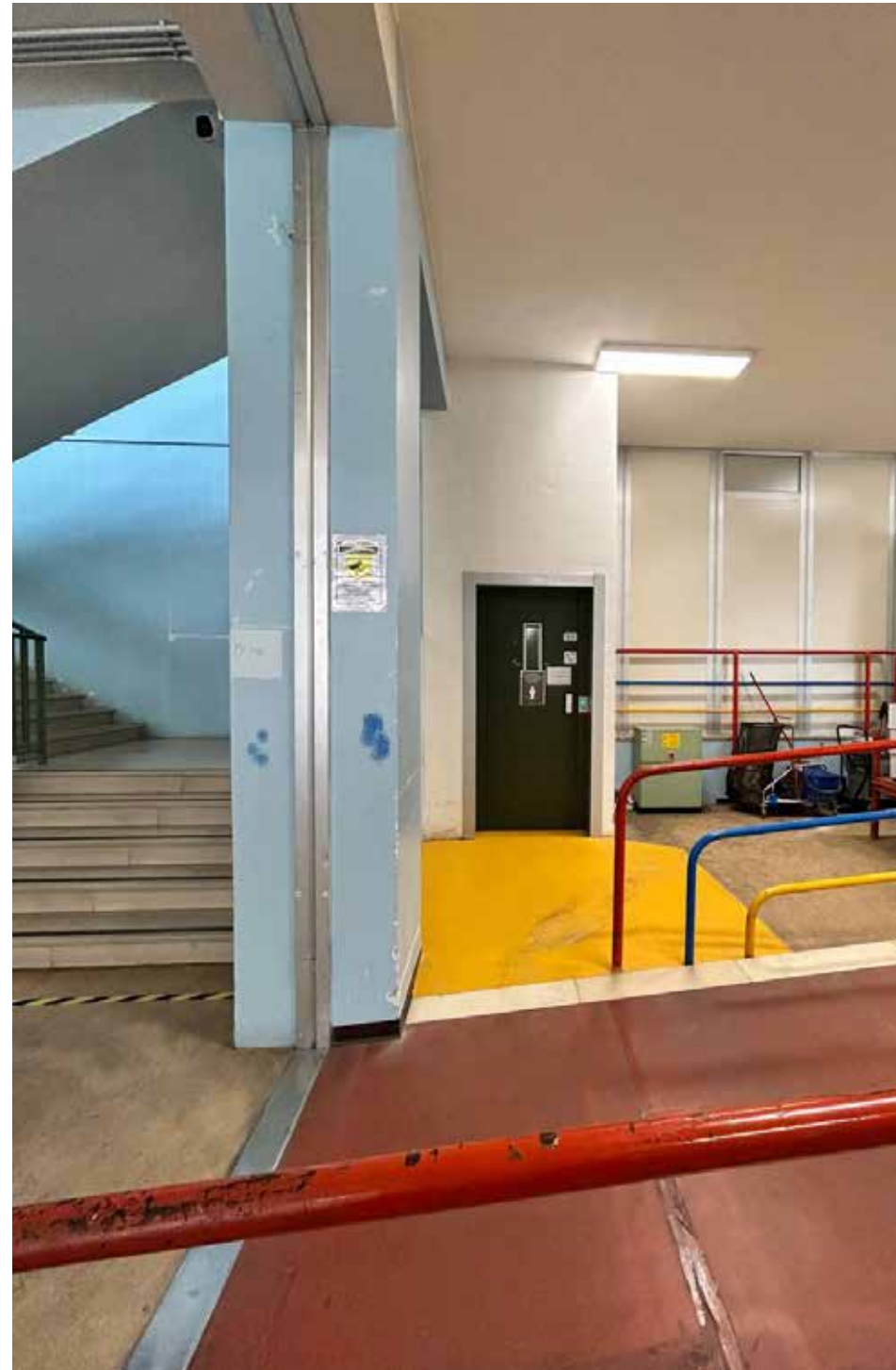
5 - Presenza di montacarichi interno in comune alle due scuole. E' caratterizzato dalla presenza di parapetti che rendono difficoltoso l'accesso alla zona del montacarichi.
