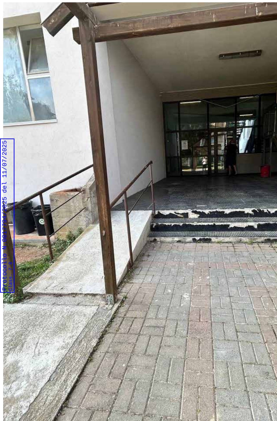
1 - Passaggio dall'Istituto Comprensivo Val Varatella alla tensostruttura. Presenza di scale e rampa con pendenza superiore all'8%.
